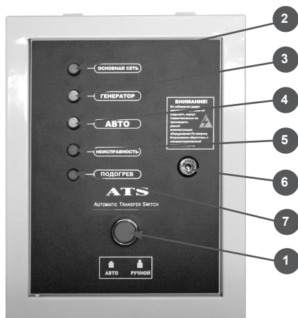
Рис. 14 Контрольная панель блока ATS
